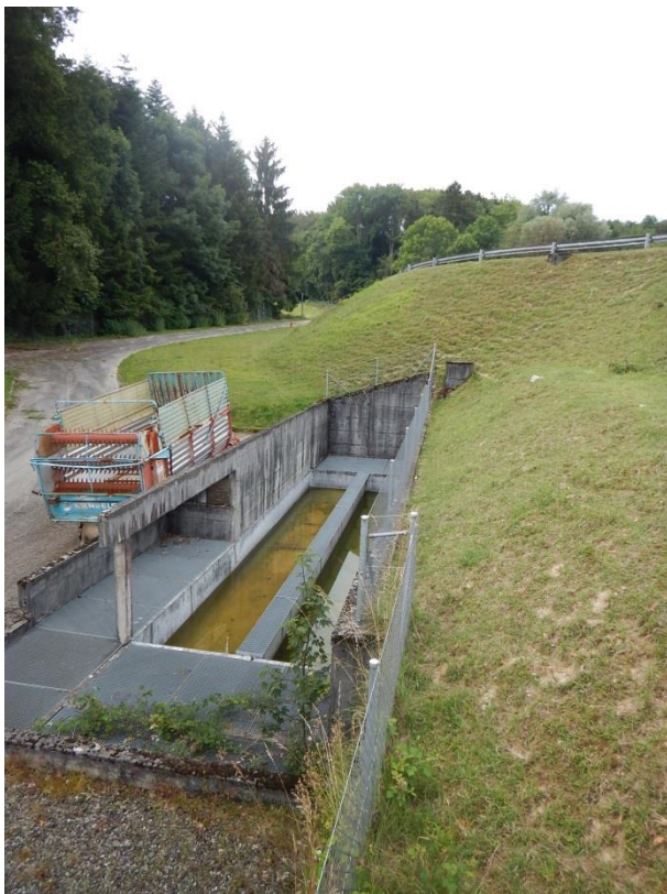
Figure 6-8 Bassin déshuileur pour les eaux pluviales des bassins
