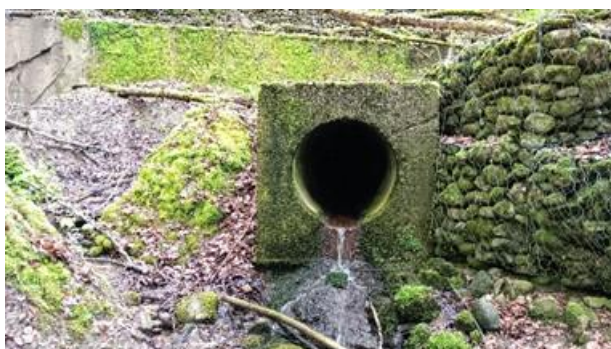
Figure 6-13: La sortie de la mise sous tuyau (2,569,769.222 E 1,186.815.798 N, 564 mns ) de l'effluent du Chandon est situé 200 m en aval de la zone de projet. Le diamètre de la conduite du cours d'eau est en béton DN 1000.
