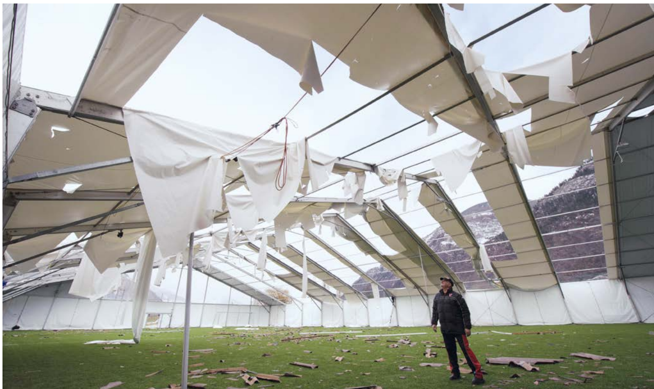
Dommages causés par la dépression cyclonale «Andrea» dans le district valaisan de Martigny en 2012
